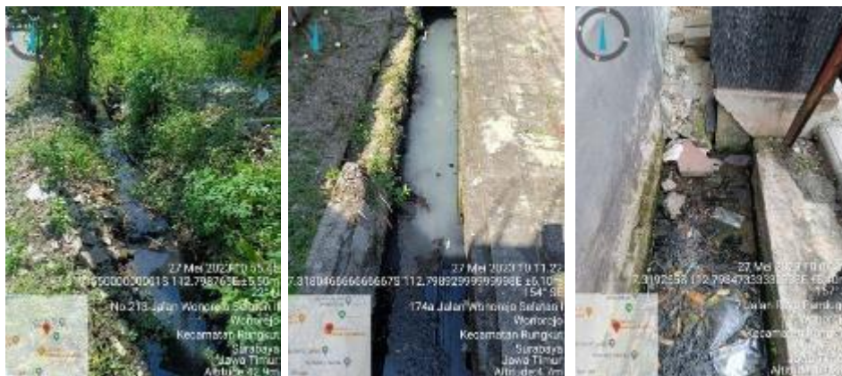
Gambar 2. Kondisi Drainase di RW 08
