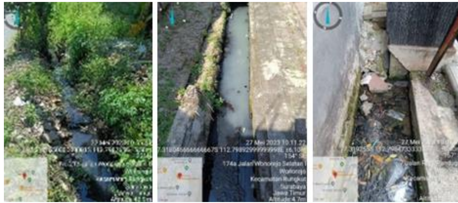
Gambar 1. Kondisi Drainase di RW 08
